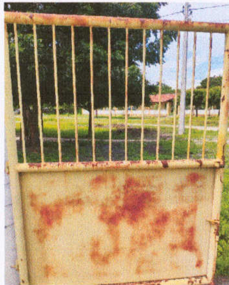
Figura 19 – Portão de entrada da ETA necessitando de nova pintura
