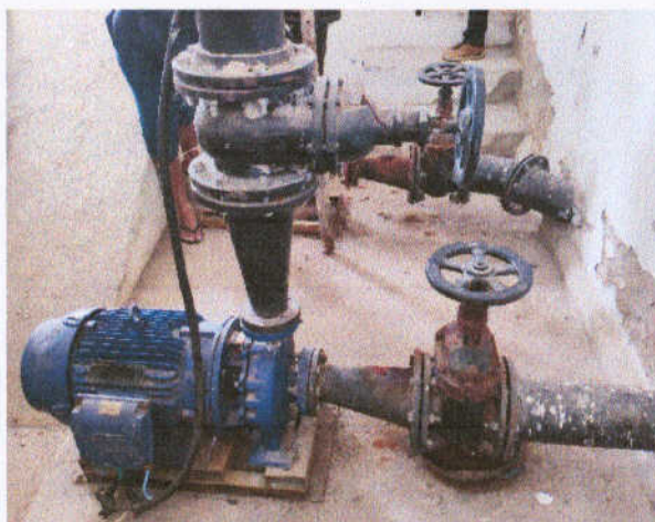
Figura 23 – Barrilete da elevatória (atual na frente e reserva atrás)
