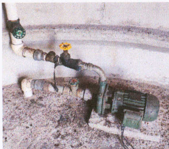
Figura 26 – Barrilete da bomba centrífuga do REL
