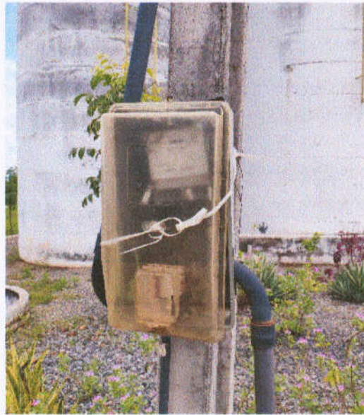
Figura 30 – Quadro de medição nos reservatórios de Santa Terezinha
