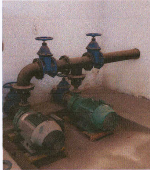
Figura 8 – Bombeamento para Timonha
