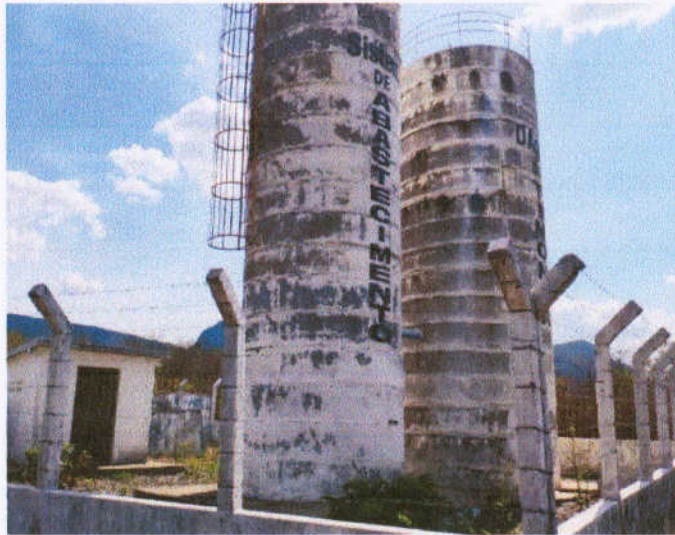
Figura 11 – Reservatórios da distribuição da Timonha
