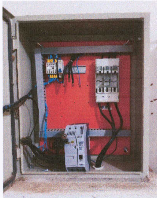
Figura 9 – Quadro defeituoso da bomba de recalque para Timonha
