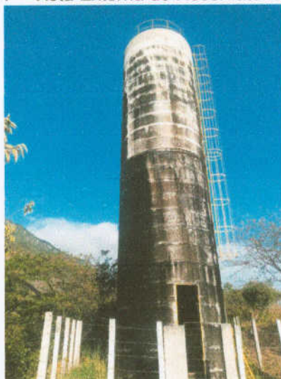
Figura 02 – Vazamentos e infiltrações devido o comprometimento da impermeabilização do Reservatório do Brejo
