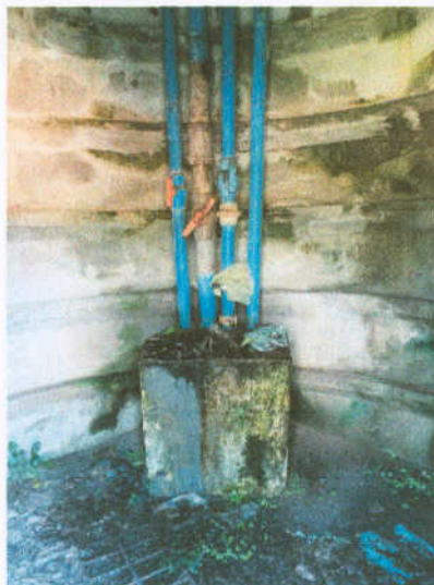
Figura 02 – Instalações Hidráulicas existentes do Reservatório do Córrego da Raiz
