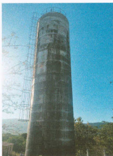
Figura 03 – Vista lateral evidenciando os múltiplos vazamentos entre os anéis do Reservatório do Brejo
