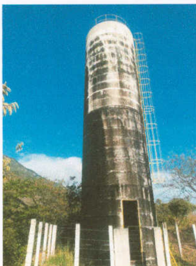
Figura 02 – Vazamentos e infiltrações devido o comprometimento da impermeabilização do Reservatório do Brejo
