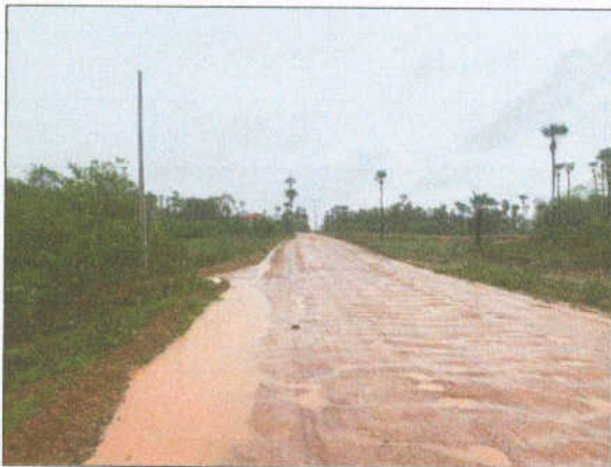
Foto 15 – trecho em revestimento primário com acúmulo de água na margem da via, no período chuvoso.
