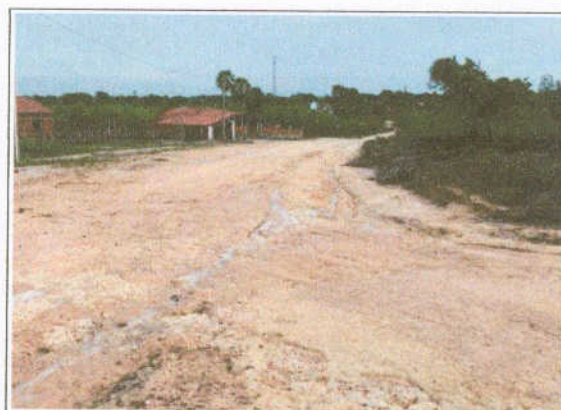
Foto 14 – trecho em estrada carroçável em péssimo estado.
