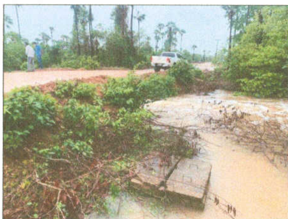
Foto 05 – boca de bueiro obstruída
