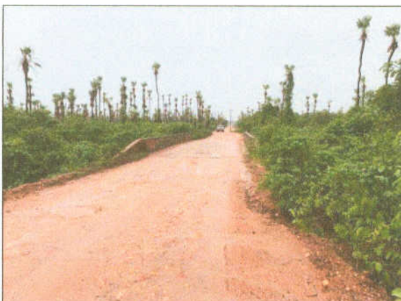
Foto 03 – estaca 1.564+15,00 vista superior de bueiro BTCC
