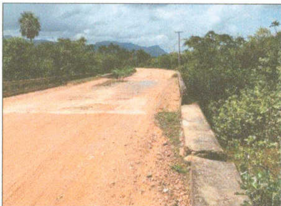
Foto 01 – estaca 942 vista superior da Ponte sobre o Rio Itaúna – laje e guarda corpo danificados.
