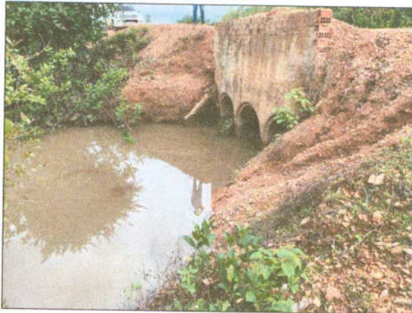
Foto 07 – boca de bueiro BTTC sem alas com muro elevado de alvenaria de tijolo
