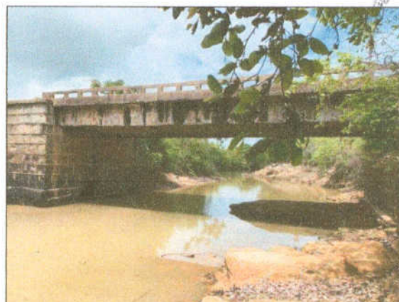
Foto 02 – estaca 942 vista lateral da Ponte sobre o Rio Itaúna – ferragens expostas.
